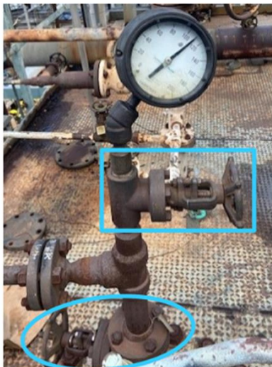
Figuur 1. Afsluiters ter isolatie van de manometer
