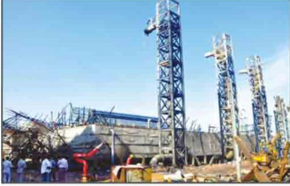
Şekil 1. Soğutma kulesi yangını
