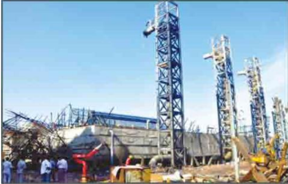
Figura 1. Incendio en torre de refrigeración
