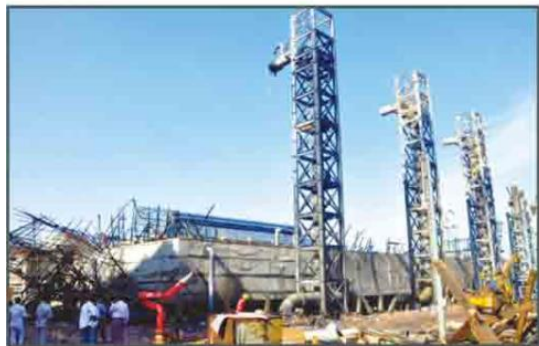
Figura 1. Incêndio na Torre de Refrigeração
