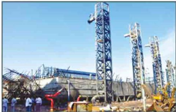
Rys 1. Pożar bloku wodnego
