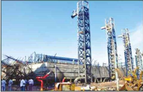
Rajah 1. Kebakaran Menara Penyejuk
