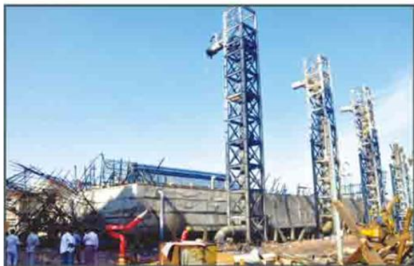
図1. 冷却塔の火災
