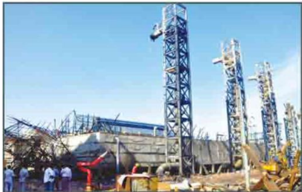
Figura 1. La torre di raffreddamento incendiata.
