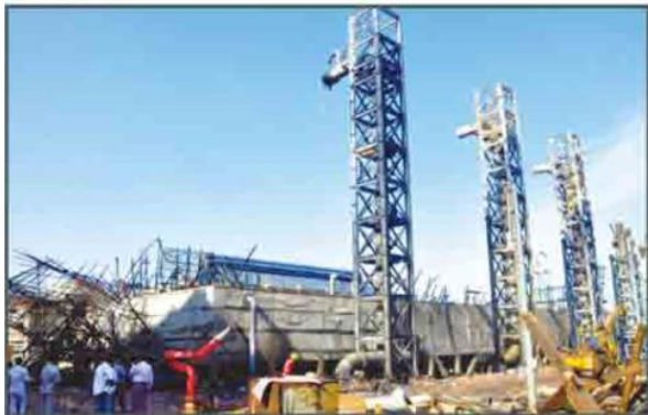
Figure 1. Incendie de la tour de refroidissement
