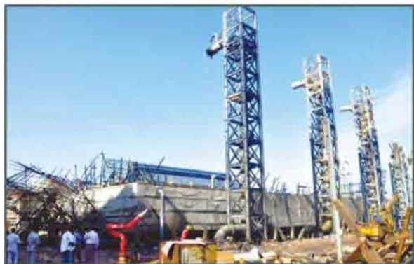
圖1：冷卻塔火災照片
