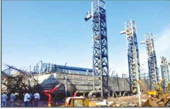
الشكل 1. حريق برج التبريد
