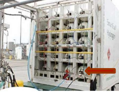
చిత్రం 1. Filling a hydrogen tube trailer
