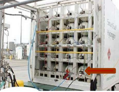
Figure 1. Filling a hydrogen tube trailer (ஹைட்ரஜன் டியூப் டிரைவ்லைர் நிரப்பதல்)
