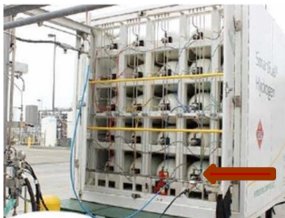
Εικόνα 1. Φόρτωση ρυμουλκούμενου οχήματος με συστοιχία κυλινδρικών φιαλών υδρογόνου (tube-trailer)
