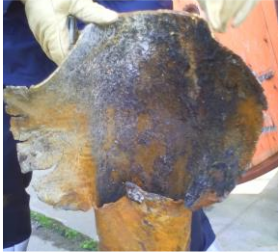
Εικόνα 1: Ο διαρρηγμένος σωλήνας
