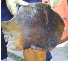
圖1：爐管破裂情形
