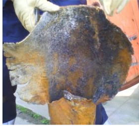
Figura 1: el tub trencat
