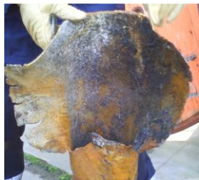
Слика 1: Пукната цевка
