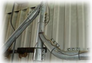
Tubo ng transportasyon na may grounding na mga kable
