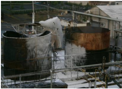
Hình 2. Bồn bể sau vụ cháy
