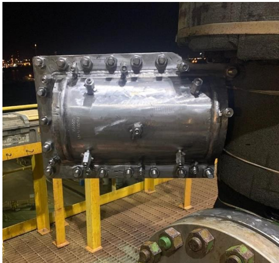
Rys 1. Tymczasowa obejma na przeciekającym zaworze
