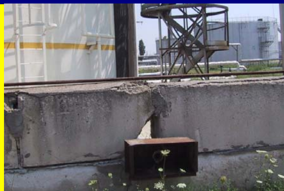
Jun – Lubang pada dinding tanggul penahanan tangki-tangki
