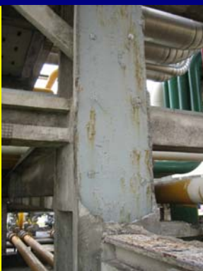
Mei – Penahan api terosak pada kolum sokongan jambatan paip
